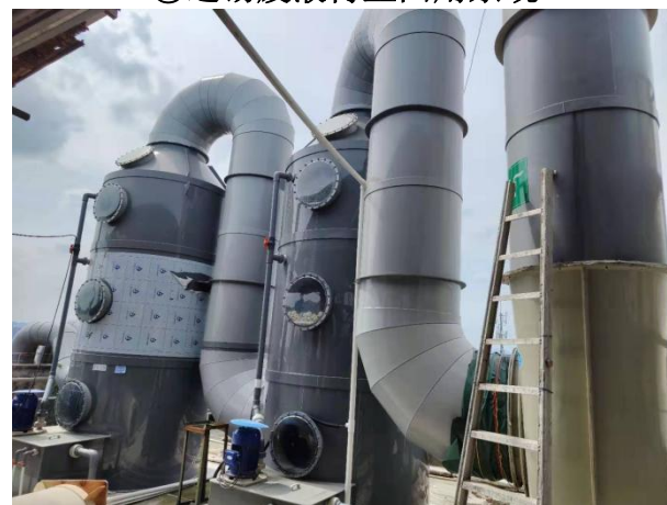
⑧废气处理设施
